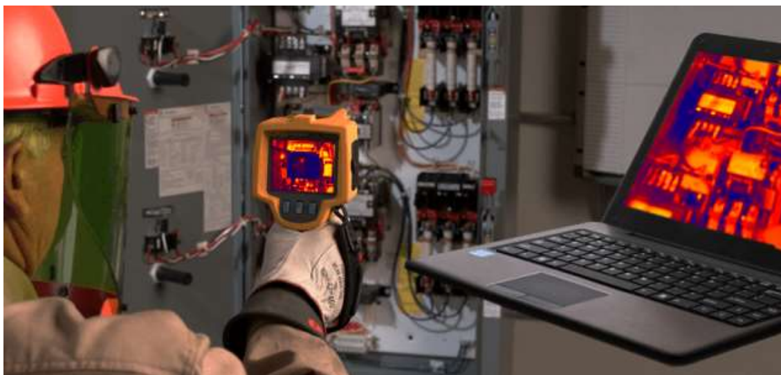
Рисунок 20. Пример проведения тепловизионного контроля электрошкафа
